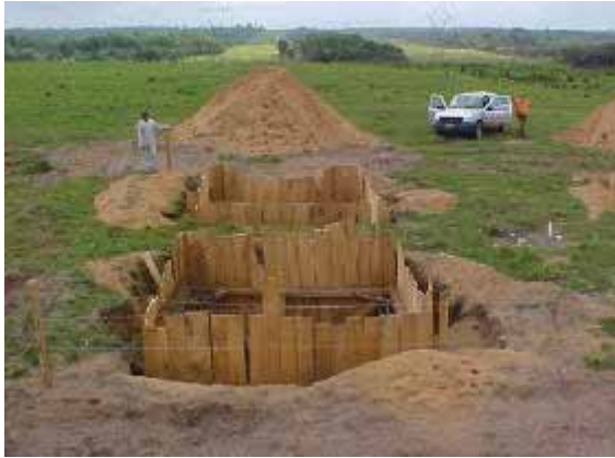
Foto 4: impacto gerado por fundação de torre autoportante
